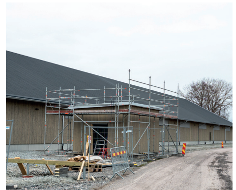
Miljöhuset är färdigt och ska få sin port samt asfalt utanför och inne i huset.
