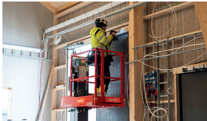
Det är en del installationer i ett modernt stall. Här jobbar Göthes med lås och larm.
