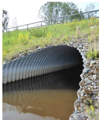
Figur 31: Trumman under vägen där det syns hur brunt vattnet var vid besöket.
