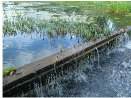
Figur 13. Trädämnet som läcker mellan plankorna. Växten hästsvans växer intill dämnet.
