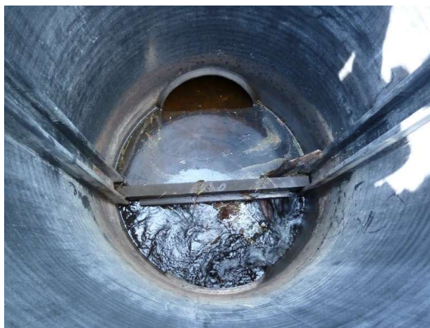
Figur 17. Insidan på munken där man ser att vattnet inte bräddar över sättarna (plankorna) utan rinner ut längre ner.
